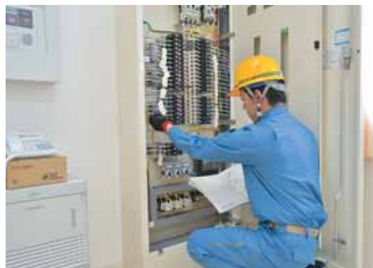
船泊こどもセンター新築工事現場で、分電盤の動作確認をする笠松さん。
