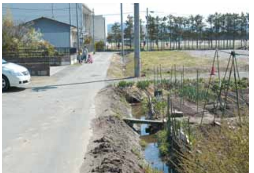
修繕が待たれる土水路（町道船岡東44号線）
