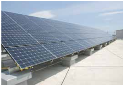
槻木中学校屋上に設置されている太陽光パネル
