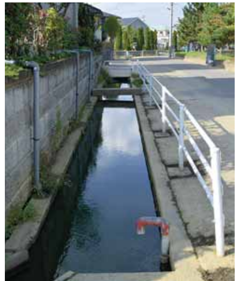
雨水が溜まる西住小学校前排水路
