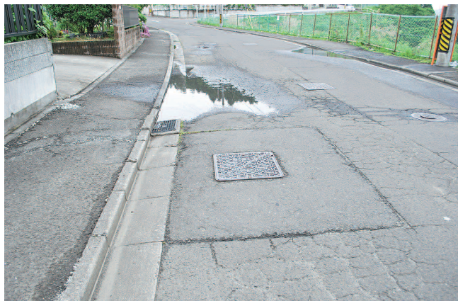
まだまだ改修が必要な道路が
