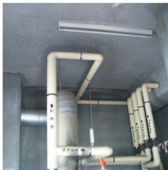
太陽の家(旧館)ボイラー館
