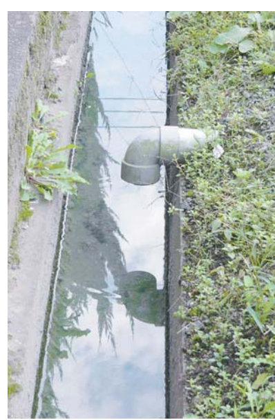
排水が流れない側溝
