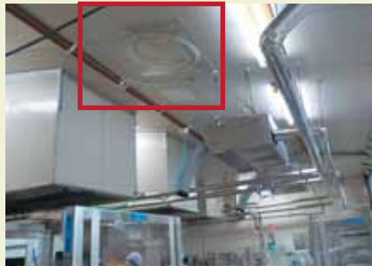
調理室 天井の暖房機へのカバー
