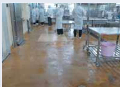
調理室 床の状態
