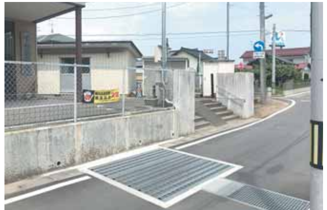
活躍が期待される常設ポンプ
