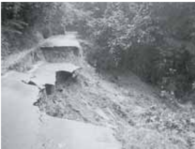
平成6年9月。町北東部に局地的な豪雨(2日間で約392ミリ)が降り、床上・床下浸水、道路の陥没、水田の冠水と土砂流入など、大きな被害が発生しました。
