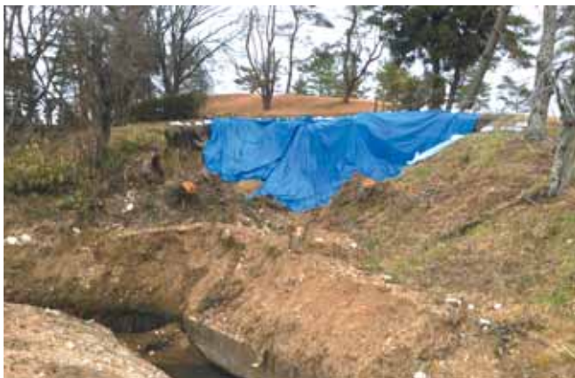
ゴルフ場内の土砂崩れ現場
