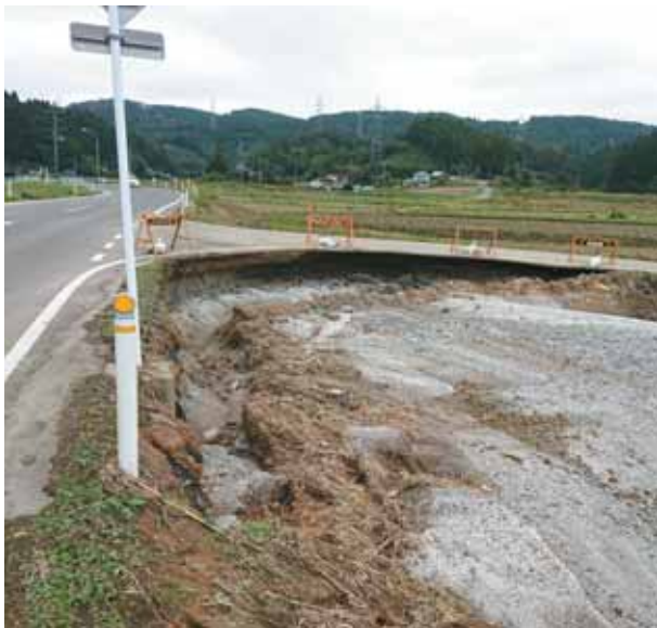
えぐられた町道(富沢地区)
