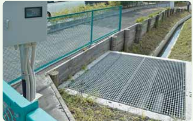
三名生排水機場南側に設置された排水ポンプ
