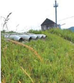
白石川右岸に設置された排水樋管
