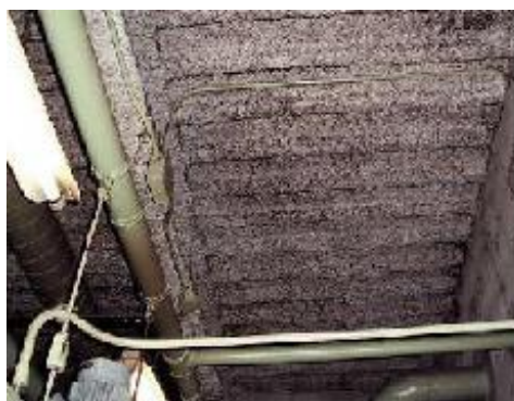
石綿含有吹付けロックウール
