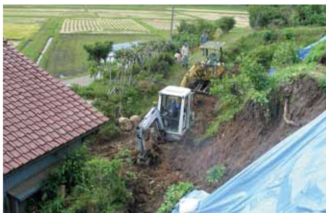
大雨で崩れた斜面(船迫地区)
